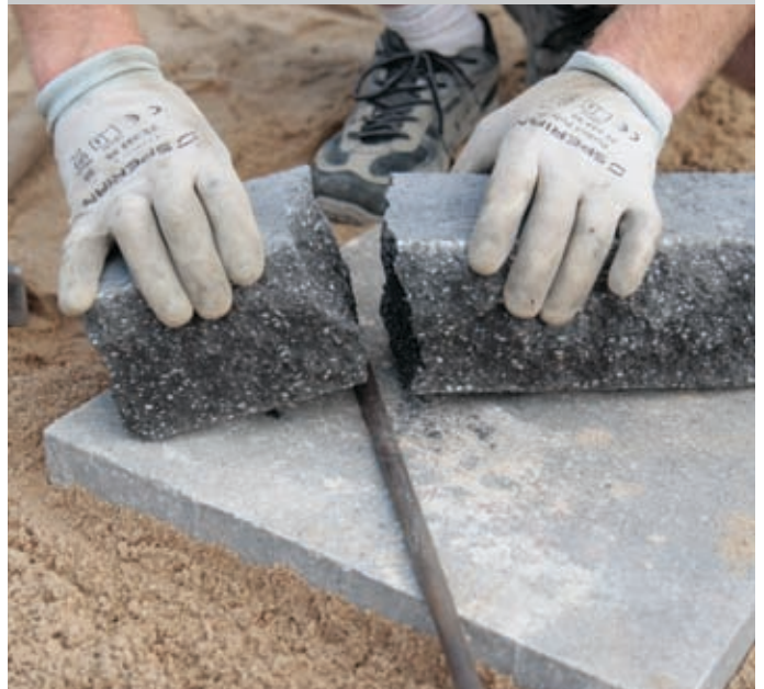
ŁAMANIE WYSOKIEGO ELEMENTU PALISADY
