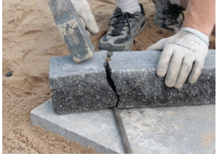
ŁAMANIE WYSOKIEGO ELEMENTU PALISADY
