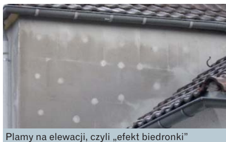
Plamy na elewacji, czyli „efekt biedronki”
