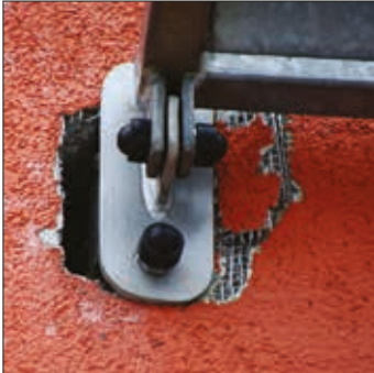
Zdj. 1 - Uszkodzenie elewacji w miejscu źle zamocowanego daszki
