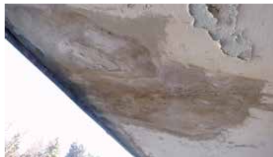
Niedostateczne uszczelnienie balkonów skutkuje ich poważnymi uszkodzeniami.
